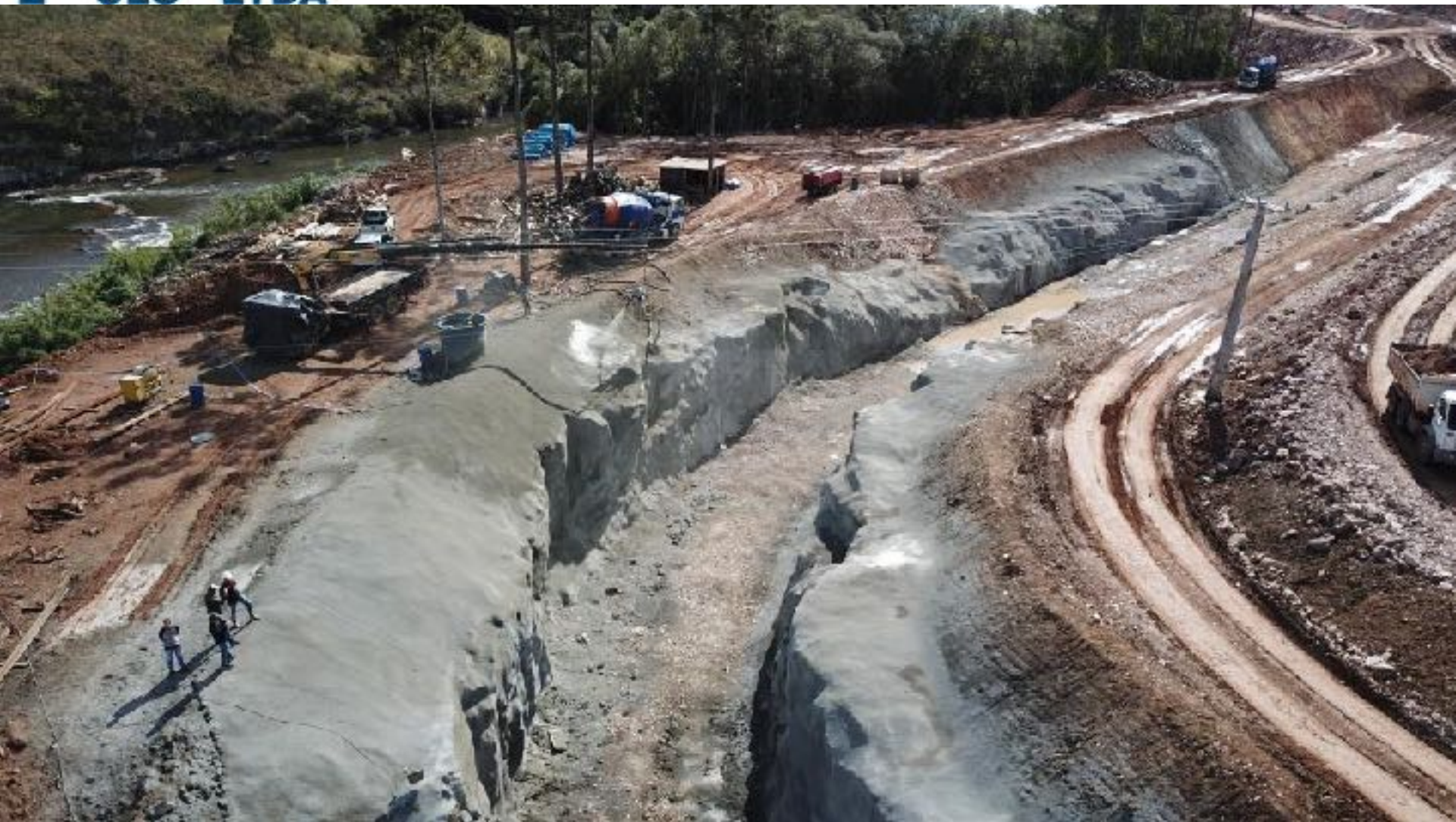
CANAL ADUTOR TRECHO EM ROCHA ENTRE ESTACAS 0 A 10 EM EXECUÇÃO TRATAMENTO EM CONCRETO PROJETADO
