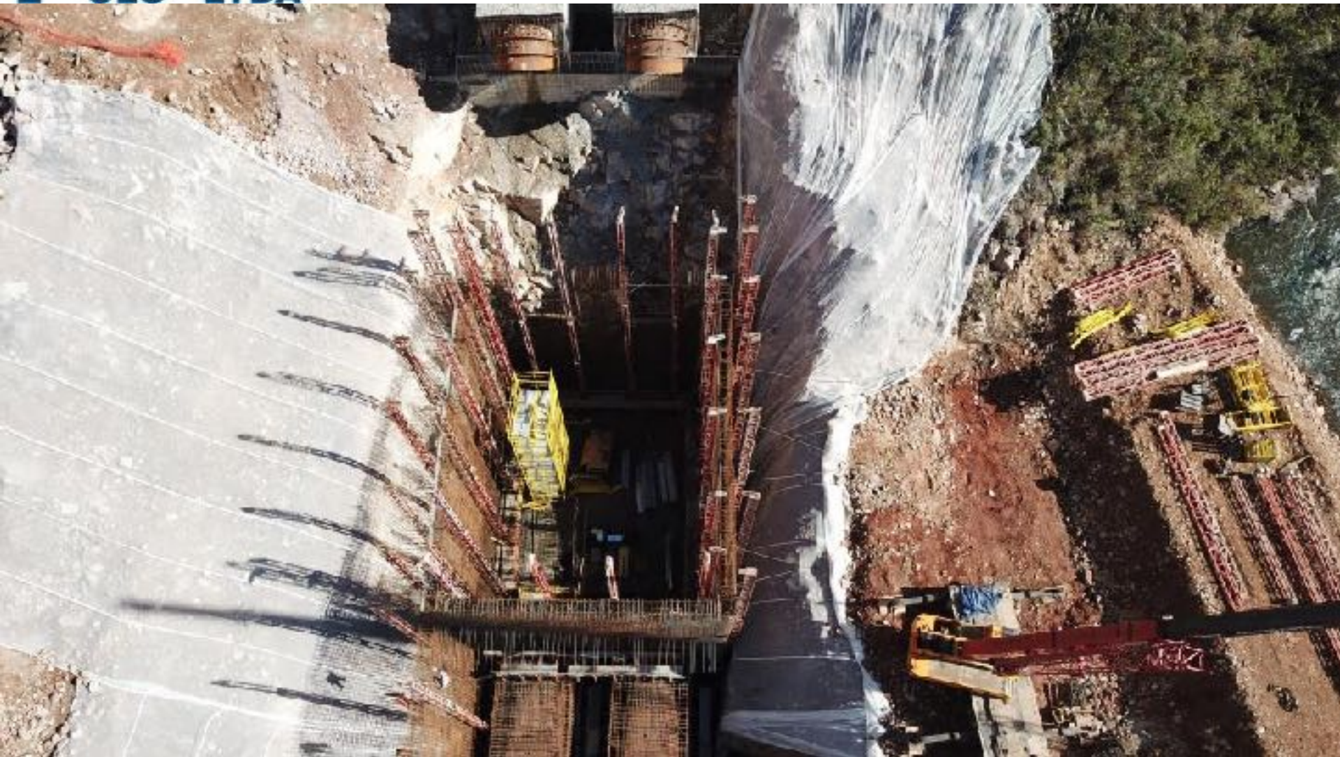
CASA DE FORÇA MONTAGENS DAS ARMADURAS E GUIAS DAS FORMAS DESLIZANTES, PREVISÃO DE INICIO DA CONCRETAGEM PARA 08/09
