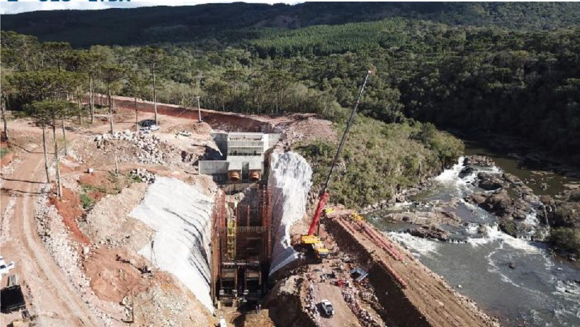
VISTA GERAL DO SETOR DA CASA DE FORÇA E CÂMARA DE CARGA
