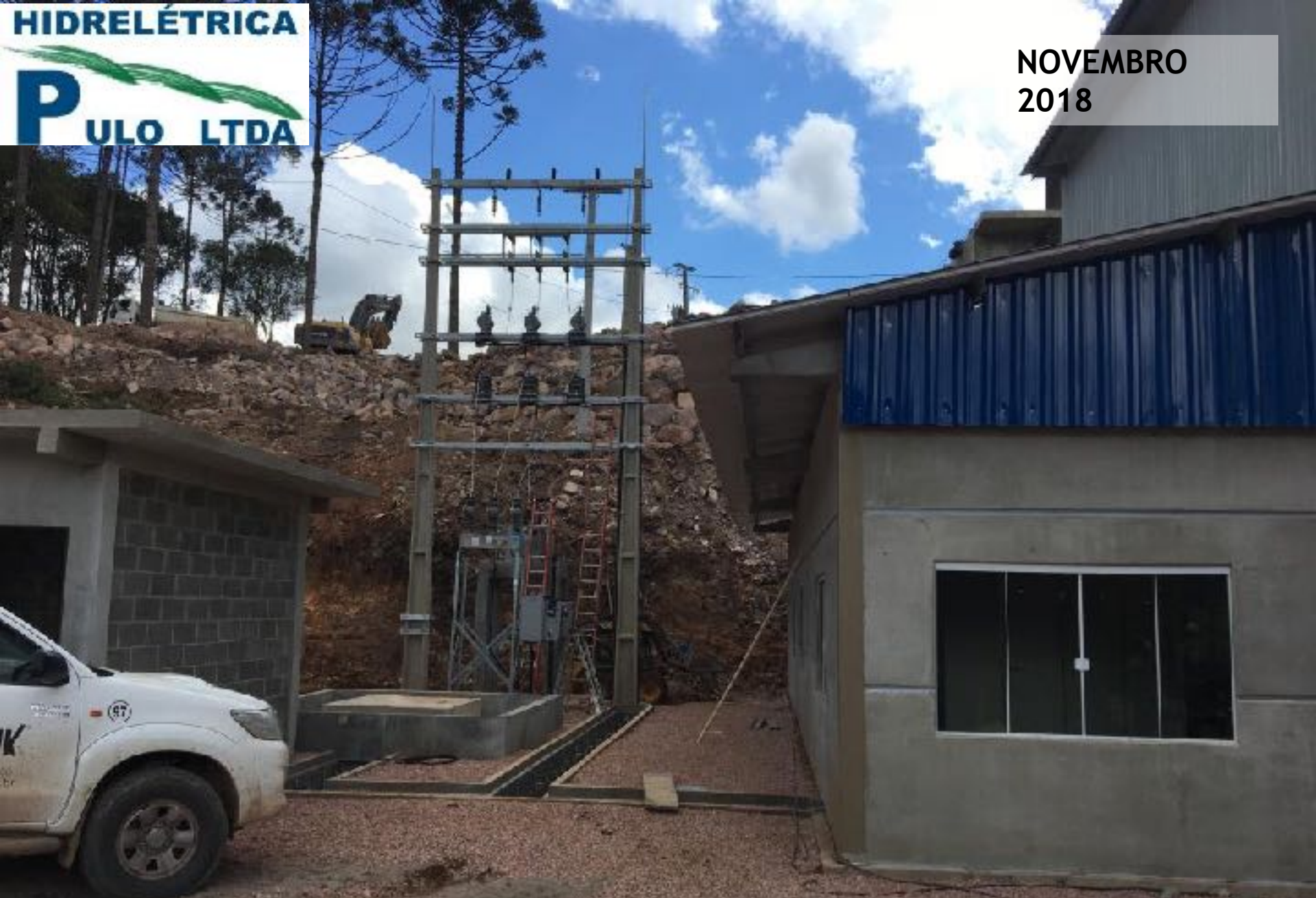
VISTA DA SALA DE COMANDO E SE AGUARDANDO O TRANSFORMADOR ELEVADOR
