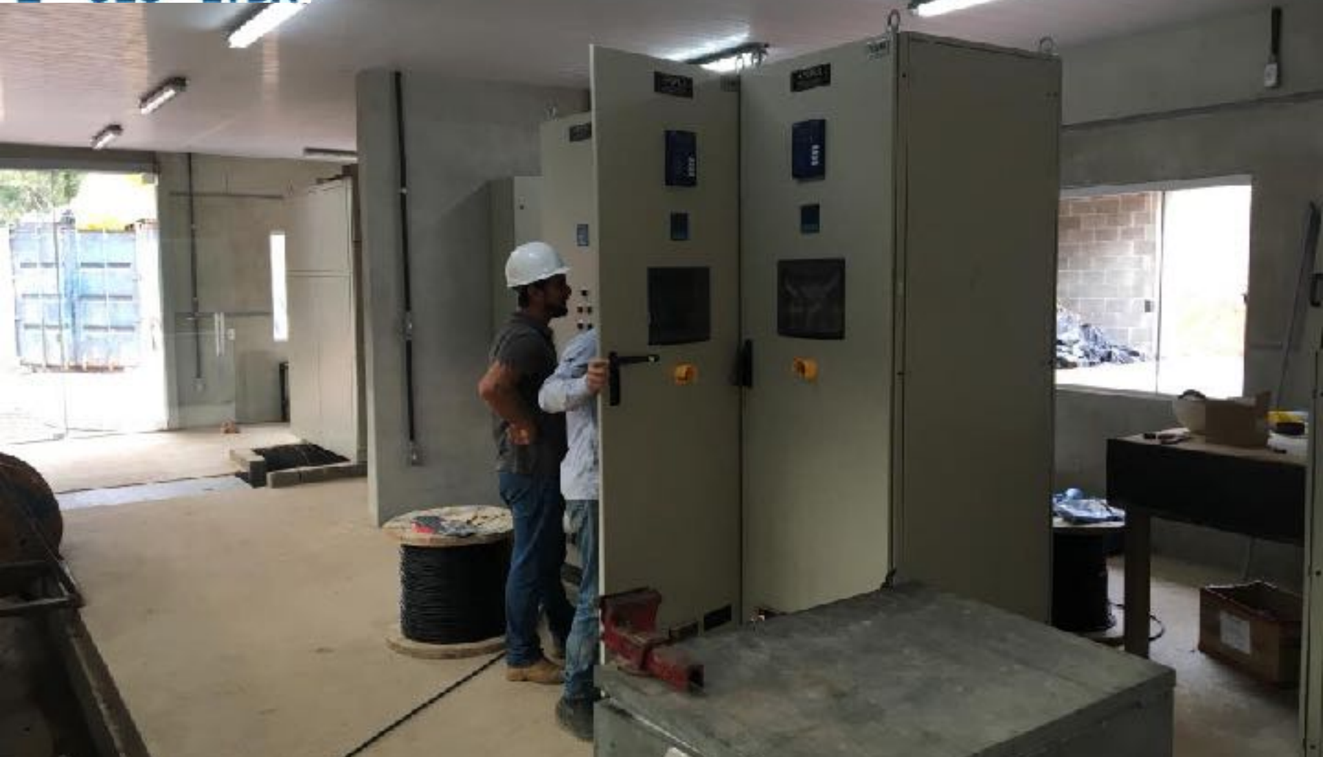
SALA DE COMANDO MONTAGEM DOS PAINÉIS E LANÇAMENTO DE CABOS EM ANDAMENTO
