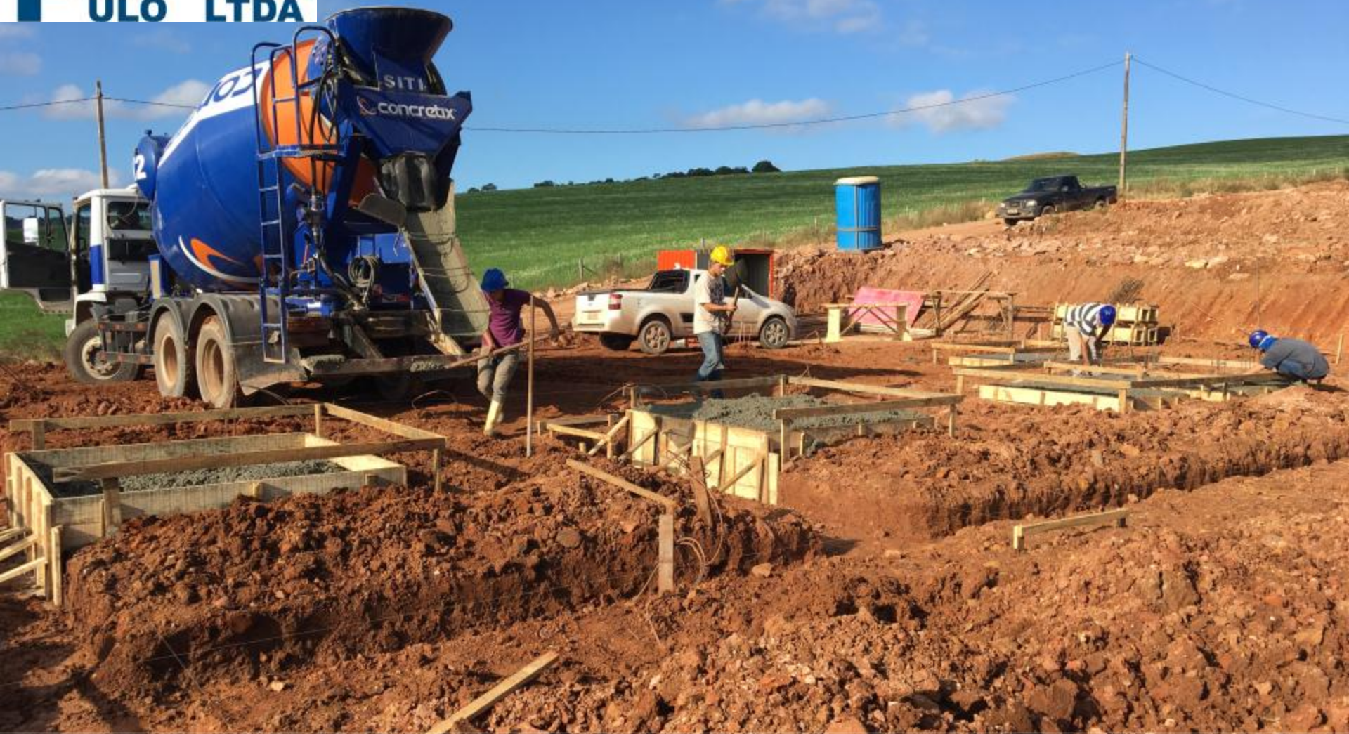
BAY DE CONEXÃO DA PCH PULO NA SE DA PCH CASTRO VISTA MAIO/17
